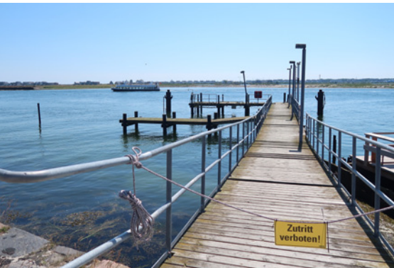
Der schwer beschädigte große Anleger
