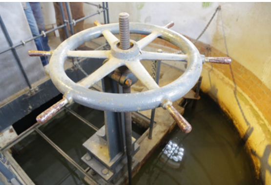
Schieber im Schieberhäuschen
